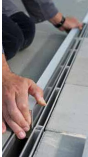
Montaža LED elementa v nastavek z rego
