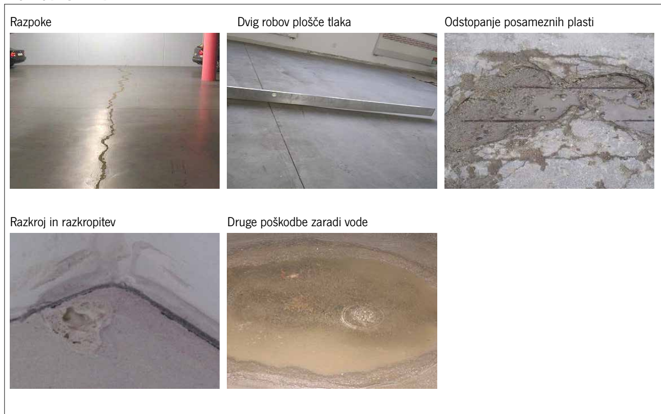
Slika 2 – Najbolj pogoste poškodbe tlakov
