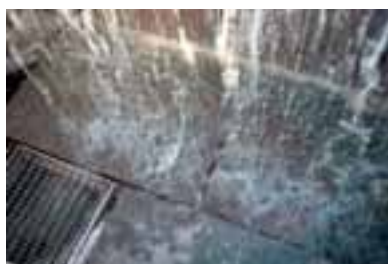
Maksimalno pršenje površine kaže pomembno funkcijo nastavnega elementa nad strešnim požiralnikom
