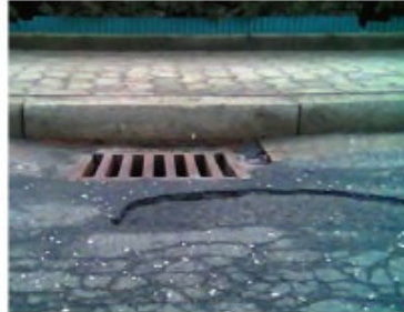
Tip poškodb A Posedanje cestišča okoli požiralnika – okvir z rešetko ostane na mestu – Posedanje – Poškodbe zaradi zmrzovanja
