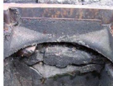
Tip poškodb B Poškodbe betonske posteljice in/ali betonski deli zaradi prometne obremenitve – Betonski jašek se uniči – Posteljica razpade
