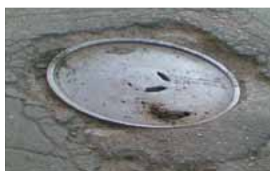
Poškodovano cestišče zaradi nizke višine okvirja
