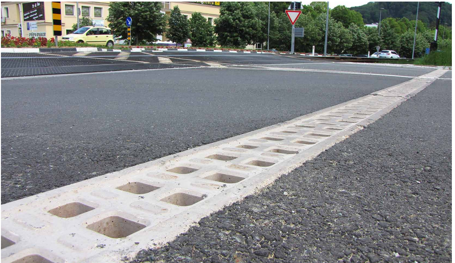
Linijski požiralnik ACO Drain Monoblock RD 200V vgrajen prečno čez vozišče.
