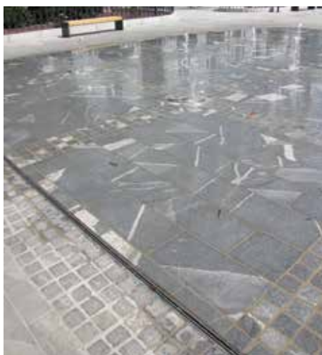
ACO SlotTop izvedba z dvojno rego. Odvodnjavanje fontane v mestnem jedru, Celje.
