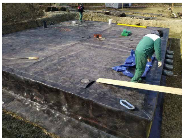
Zadrževalnik dimenzij 10,8 x 9,0 x 0,9 m, s prostornino 85 m 3 , je vgrajen pod parkirnimi prostori za kupce. Debelina prekritja (zasipna zemljina in zgornji ustroj parkirišča) znaša 1,4 m.
